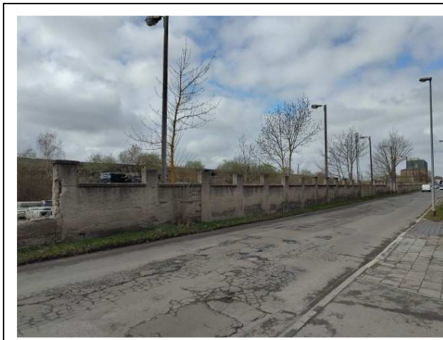
Blick von der „Lange Straße“ in Richtung Westen Foto: Stadtplanungsbüro Meißner & Dumjahn
